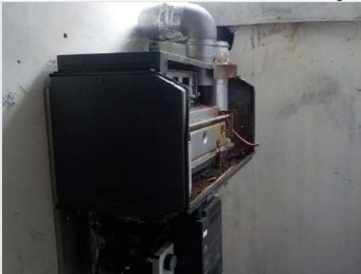
Atag cv-ketel in rechter woonvleugel: onverdacht
