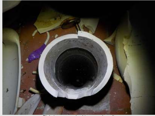
Riolering van pvc (rechter woonvleugel)
