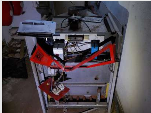
cv-ketel Burnham BG 5005, linker woonvleugel: niet asbesthoudend
