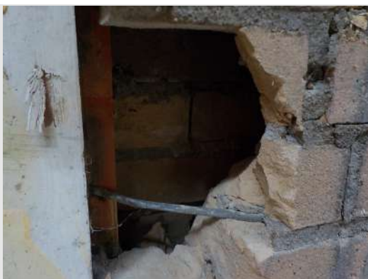
Spouwblad: geen asbestbron naast de kozijnen
