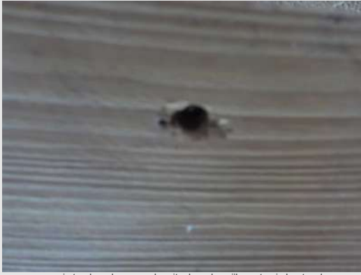
cv-ruimte: door de saneerder uitgeboorde spijkergaten in houtwerk
