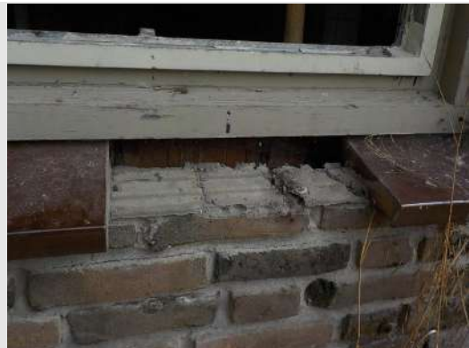
Spouwblad: geen asbestbron onder kozijnen
