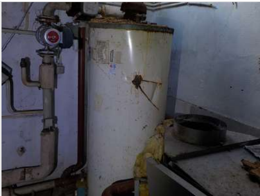
Boiler in cv-ruimte: geïsoleerd met glaswol
