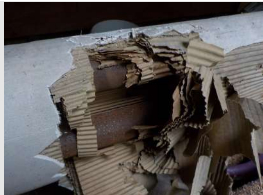
Alle cv-leidingen zijn geïsoleerd met karton en gips
