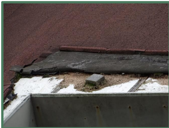
Afbrekende bitumen dakbedekking
