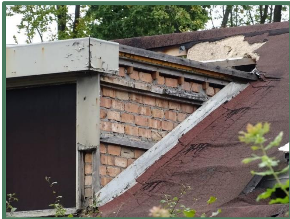
Beschadigde dakkapel met enkele planten groeiend in de goot
