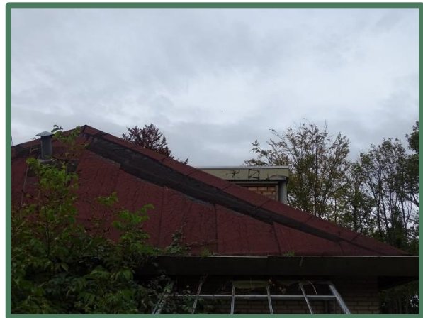
Ontbrekende laag bitumen en beschadigde dakkapel
