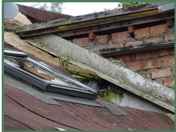
Dakkapel waarvan de buitenmuur is vervallen
