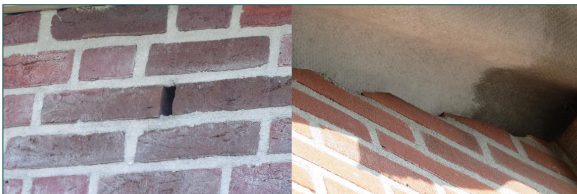
Figuur 3.1 De golfplaten sluiten niet aan op de bakstenen en er zijn open stootvoegen aanwezig.
