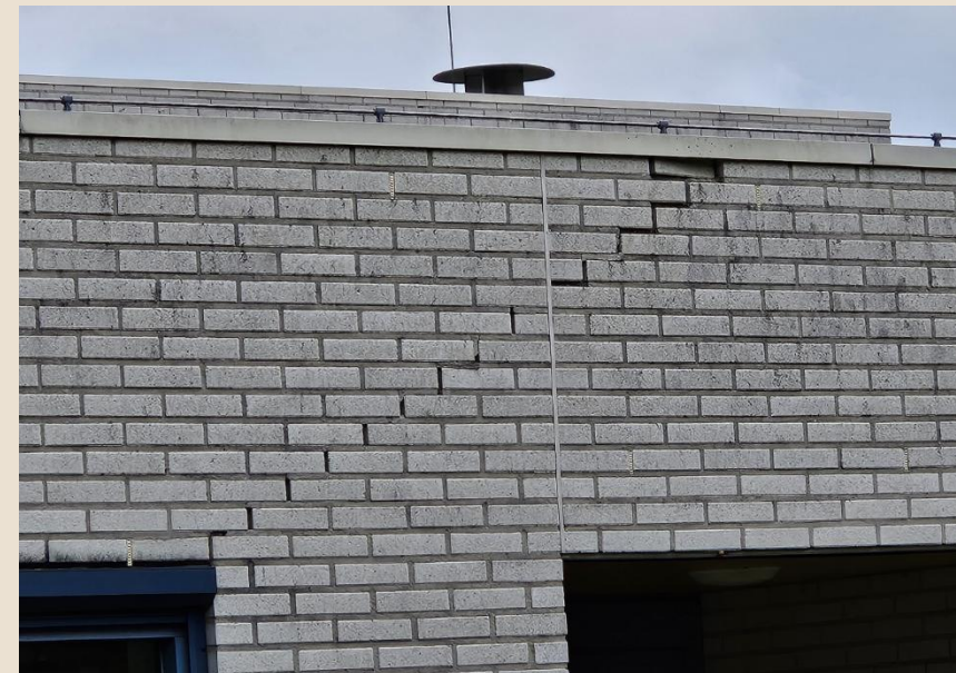
Figuur 20: Locatie 4, kieren in de zuidelijke gevel van de bebouwing
