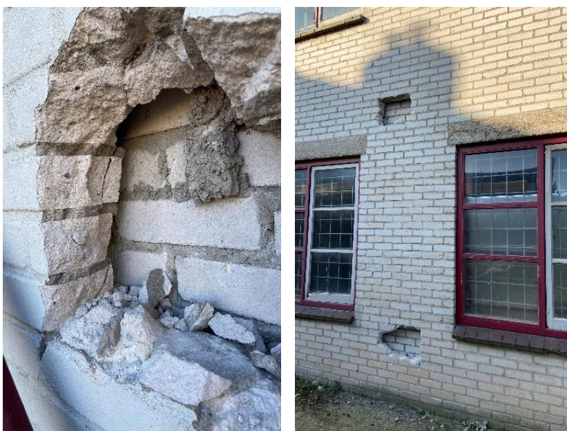
Afbeelding 3. Aanwezige tochtgaten in de muur van het bijgebouw. Opname: 2 maart 2023.
