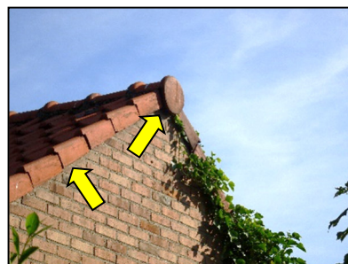
Figuur 9. Voorbeeld van ruimte tussen gevel en overhangende dakpannen en nokvorst.
