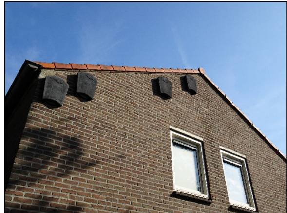
Figuur 12. Vleermuiskasten aan gevel van de Patrijsweg 3.
