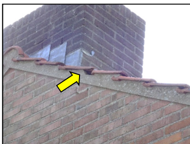
Figuur 8. Voorbeeld van opening tussen gevel en dakpan.
