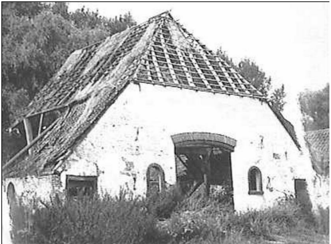
Afb. 13: De schuur uit 1773 volledig vervallen kort voor de sloop. Foto SHBO. RCE Beeldbank
