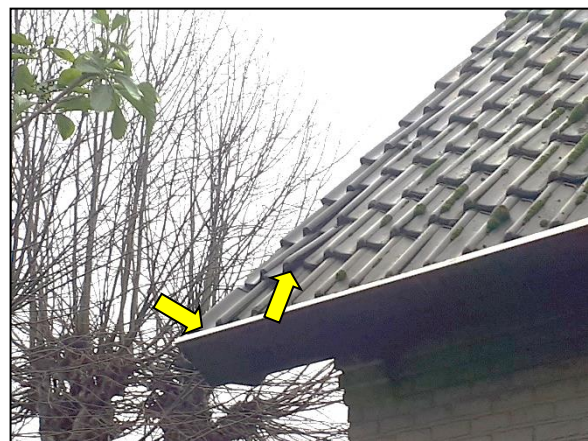
Figuur 11. Toegang onder dakpannen via de dakgoot en losliggende dakpannen.
