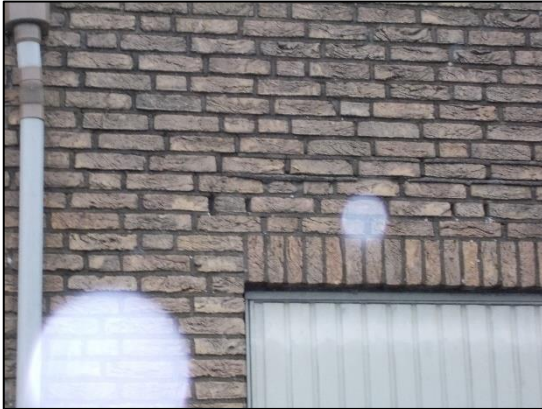
Figuur 6. Open stootvoegen en kieren
