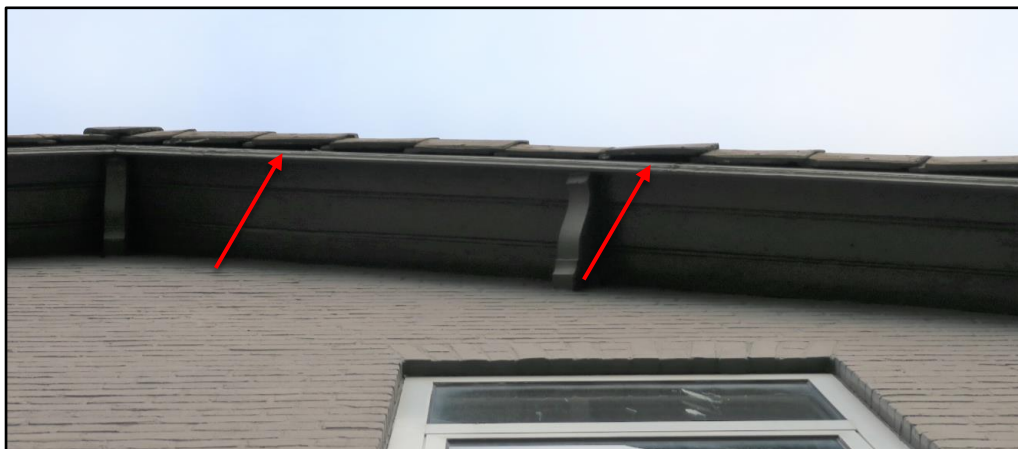
Figuur 4 Kierende kantpannen welke toegang geven aan geschikt dakruimte welke vleermuizen kunnen gebruiken om een verblijfplaats te vinden.
