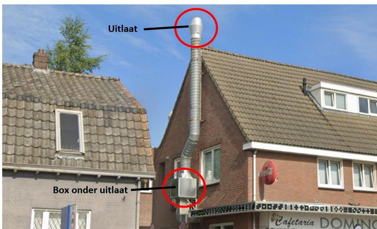
Figuur 3-1 afzuiging frituuroven met de box onder uitlaat en de uitlaat
