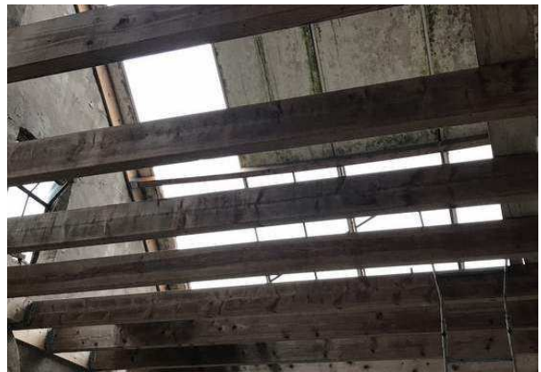
Figuur 11. Dak interieur van het voorste deel van de vervallen schuur.
