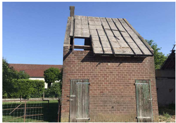
Figuur 9. Voorste deel van de vervallen schuur.
