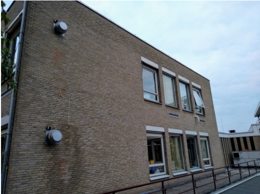
Figuur 6 Verblijfplaats van kraamkolonie in 2020. De dieren kropen onder de aluminium dakrand. De vleermuizen kunnen via deze route waarschijnlijk de spouw of holle ruimten onder het dak bereiken.
