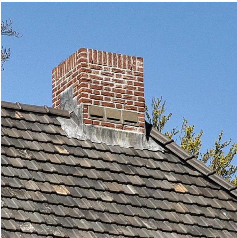
Figuur 6. Voorbeeld van drie ingemetselde inbouwstenen IB-VL-01 in schoorsteen (bron Vivara Pro).
