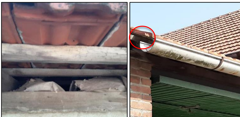
Figuur 3 Dakbeschot ontbreekt aan de buitenzijden van de garage aan schuur F (links). De toegang tot de dakruimte wordt geblokkeerd door een houten balk (rechts).
