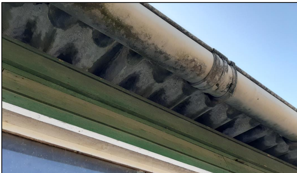
Figuur 4 Dakbeschot ontbreekt aan de buitenzijden van het golfplaten dak van schuur E.
