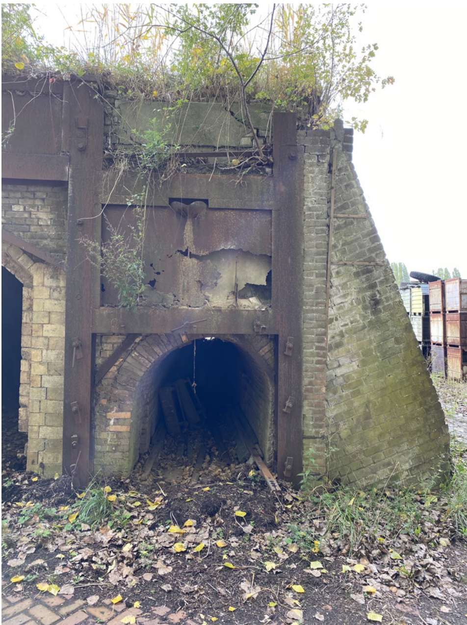
Lage tunnel die ervoor zorgt dat de warme of koude lucht van de ene naar de andere kant kan worden geleid
