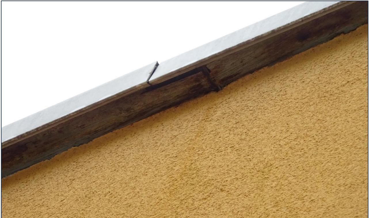
Afbeelding 6.1: Overhangende platte dakrand met houten beplating aan de onderkant. De aanwezige scheuren bieden toegang tot de ruimte die zich tussen het platte dak en de houten beplating bevindt.
