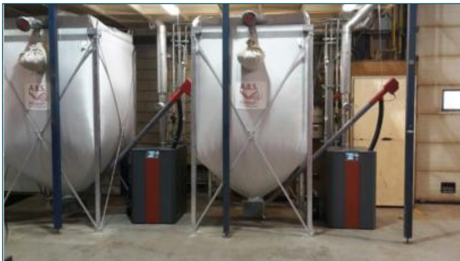
Figuur 10 – Opstelling van biomassaketels
