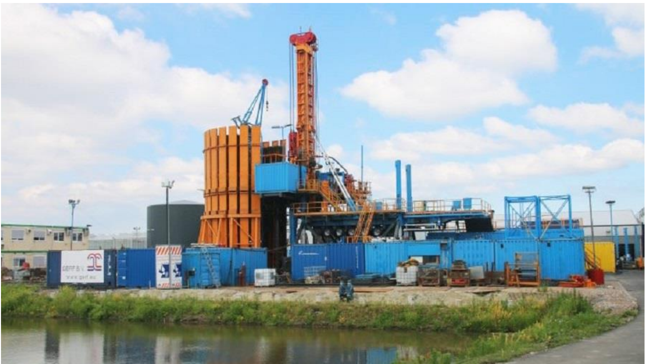
Figuur 9 – Geothermieproject in het Westland
