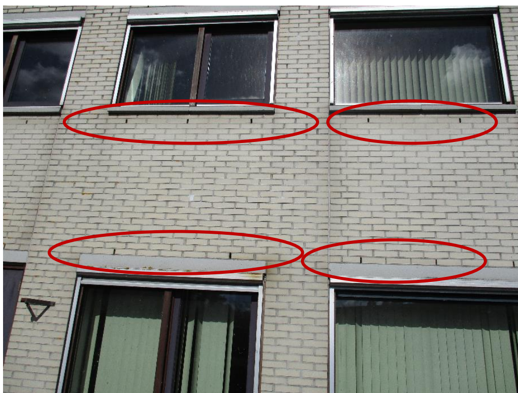
Figuur 2 Aan de gevels en aan de daken zijn een groot aantal openingen aangetroffen welke vleermuizen mogelijk verblijfplaatsen kunnen bieden. Ten aanzien van de soortgroep dient aanvullend onderzoek uitgevoerd te worden om de aan- of afwezigheid vast te stellen.
