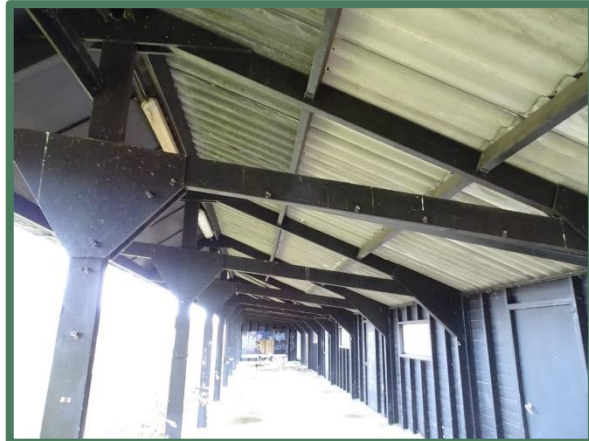
Overzicht onderzijde dak vervallen overkapping
