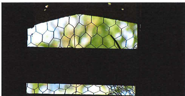
Figuur: de loods biedt geen toegang aan grote vogels zoals uilen, omdat de openingen zijn afgesloten.
