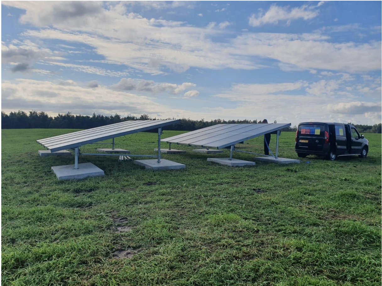
Figuur 6: Plaatsing proefopstelling op locatie.
