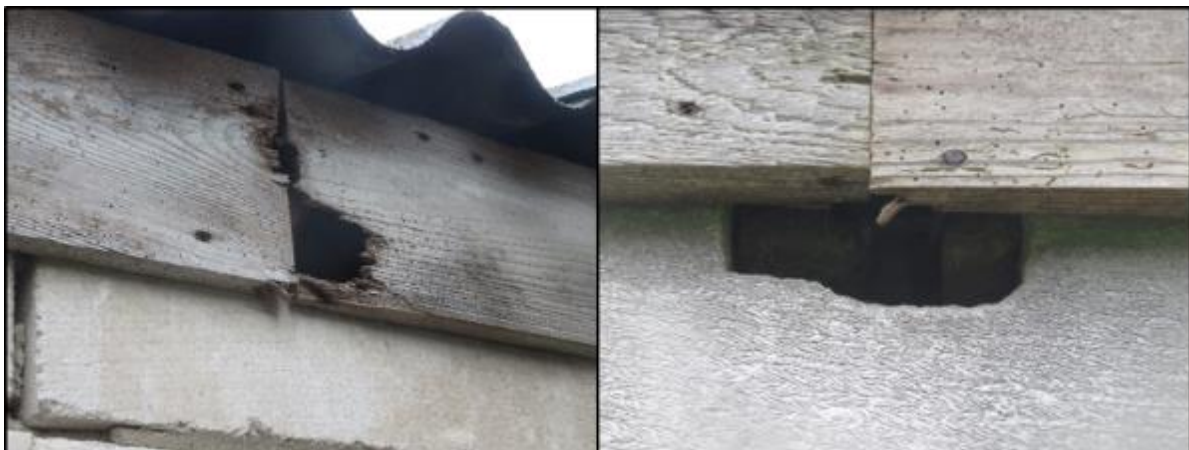
Figuur 2.8. Gaten in de daklijst van stallen 1 en 2.
