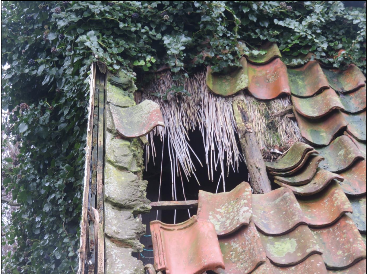
Figuur 2.7. Een ingezakt gedeelte van het dak van het bijgebouwtje maakt deze toegankelijk voor kerkuilen.
