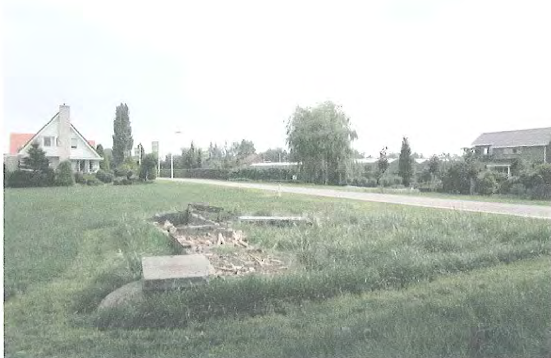
Huidige situatie met nog aanwezige fundering
