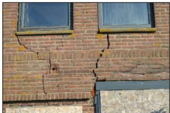
Scheuren in voegwerk van stenen pand.
