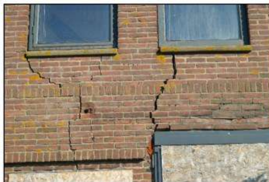
Afbeelding 2.3. Scheuren in voegwerk van stenen pand.
