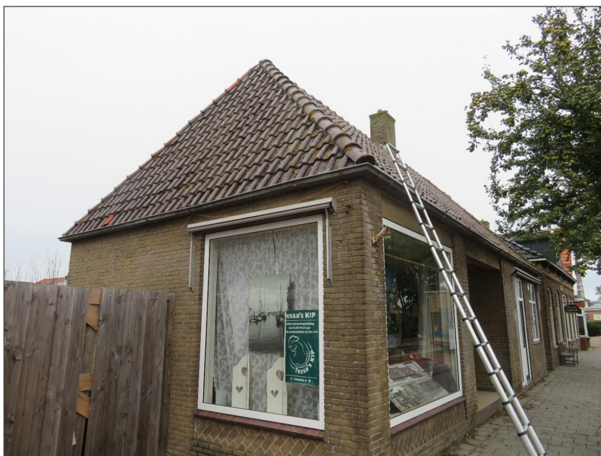
Afb 9: In metselwerk geen openingen
