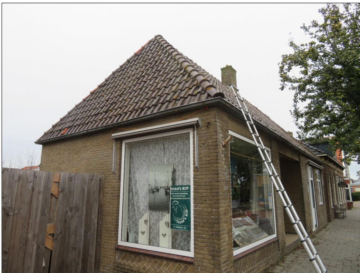
Afb 9: In metselwerk geen openingen
