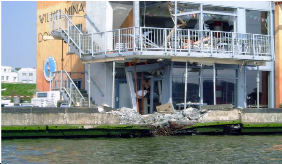
Afbeelding 10 Schade Restaurant Wilhelminadok (Bron Rijkswaterstaat)
