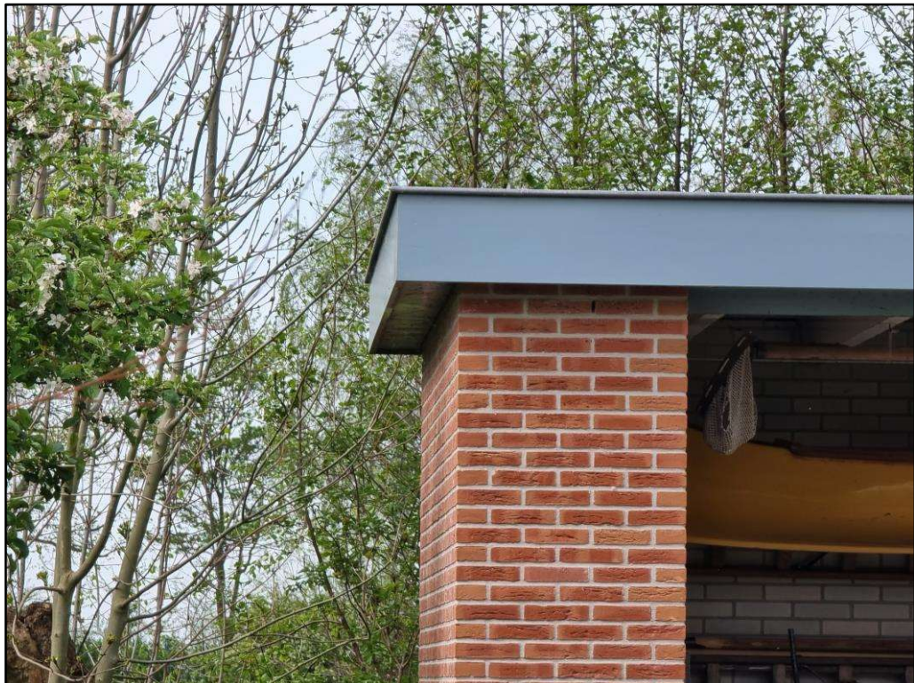
Figuur 4 De schuilgelegenheid bevat open stootvoegen waar mogelijk vleermuizen toegang tot spouwruimte kunnen vinden.
