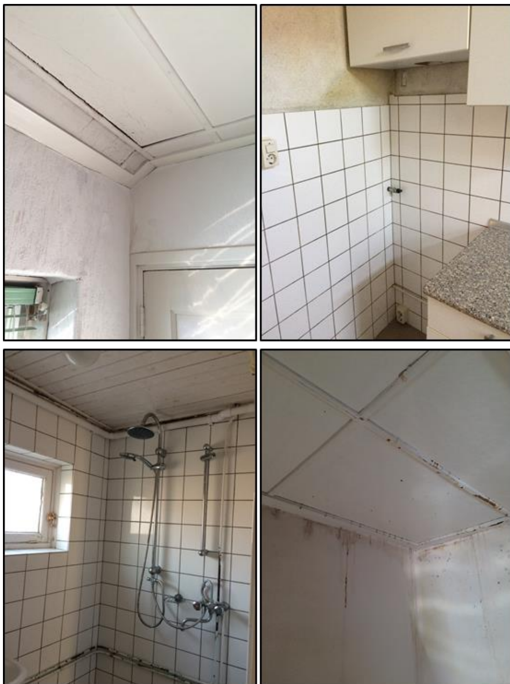
Figuur 17 In de woningen worden momenteel veel klachten gemeld met betrekking tot de huidige slechte staat van de woningen. Vochtproblemen bevat een groot aantal van de klachten die QuaWonen binnenkrijgt (bron: QuaWonen, interne foto's).
