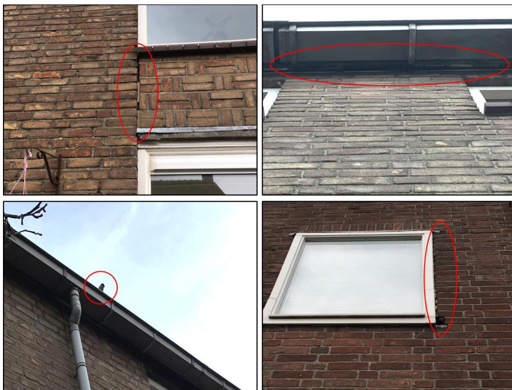
Figuur 3 Tijdens een oriënterend onderzoek zijn de woningen aan de Sint Eloystraat e.o. nauwkeurig geïnspecteerd op potentiële openingen. In de woningen is er sprake van onder andere openingen en ontbrekende specie in de muur. Tevens is er een ruimte aanwezig tussen de dakgoot en de muur. Hierdoor kon de aanwezigheid van nestlocaties van gierzwaluw en vaste rust- en verblijfplaatsen van vleermuizen niet uitgesloten worden. Tijdens het veldbezoek zijn er een aantal huismussen waargenomen op de dakgoot van de woningen. Daarbij is de onderste rij dakpannen toegankelijk. Huismus nestlocaties konden derhalve niet uitgesloten worden (bron: Rebergen, 2018).
