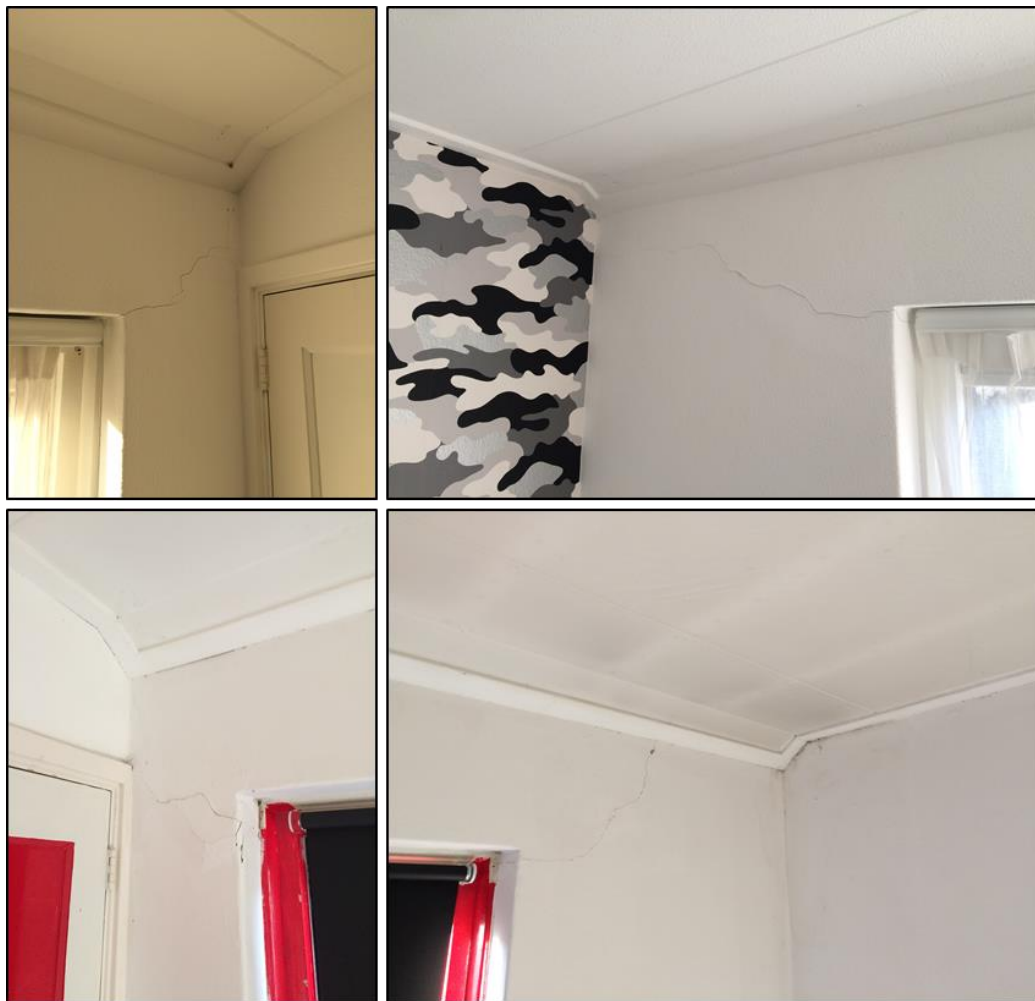
Figuur 16 In de woningen worden momenteel veel klachten gemeld met betrekking tot de huidige slechte staat van de woningen. Scheuren in de muren van binnenuit is een veelgehoorde klacht (bron: QuaWonen, interne foto's).
