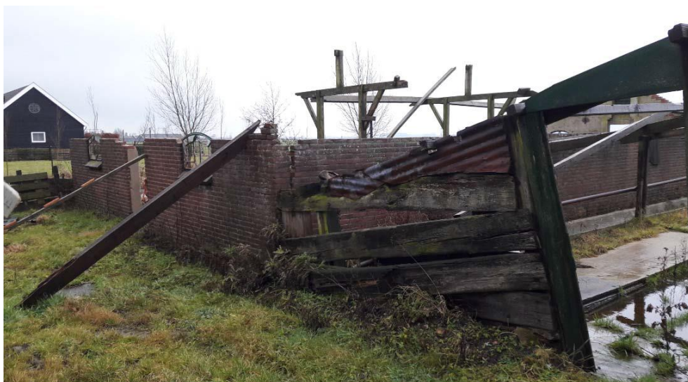
Afbeelding 5: Vervallen bebouwing IJsseldijk-Noord 100 (deel 1)
