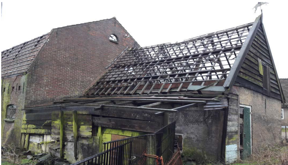
Afbeelding 9: Vervallen bebouwing IJsseldijk-Noord 100 (deel 5)
