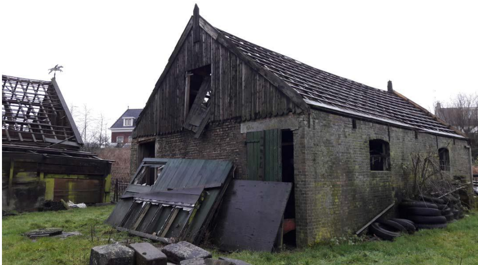
Afbeelding 8: Vervallen bebouwing IJsseldijk-Noord 100 (deel 4)
