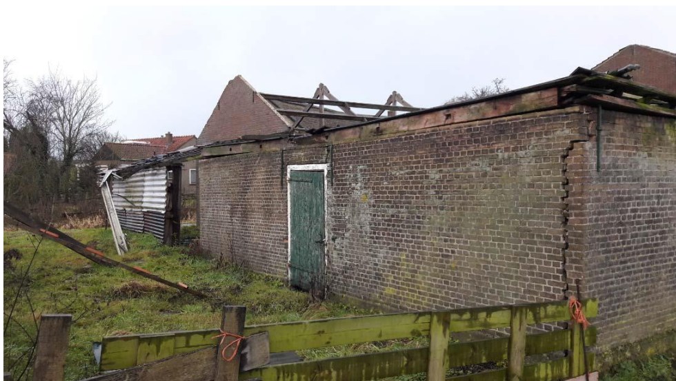
Afbeelding 6: Vervallen bebouwing IJsseldijk-Noord 100 (deel 2)
