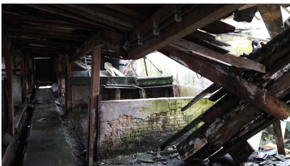
Afbeelding 7: Vervallen bebouwing IJsseldijk-Noord 100 (deel 3)
