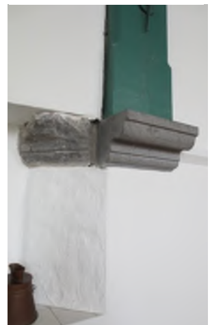
Restant van de kraagsteen ter hoogte van de transept van de zuidgevel.
