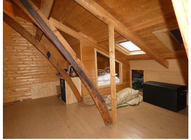
Op sommige plaatsen is een schenkelspant aangepast.
