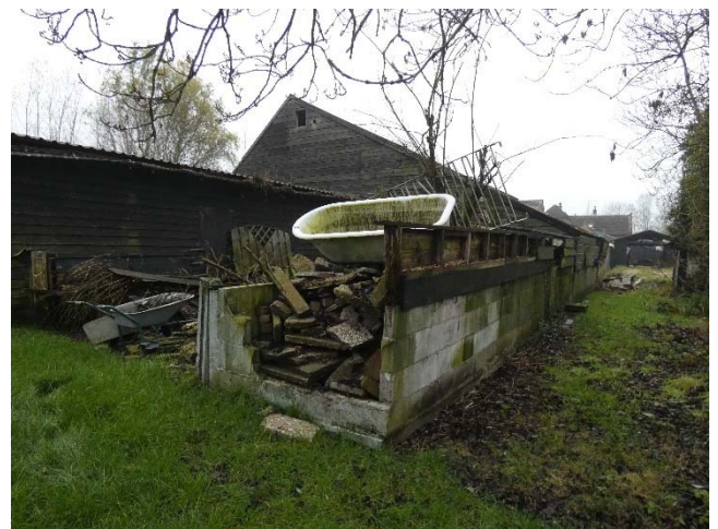
Tegen de linker zijgevel van het schurencomplex werd in de jaren '60 een varkensschuur gebouwd. Het dak en de achtergevel zijn verdwenen, waardoor alleen de contouren nog overblijven.
