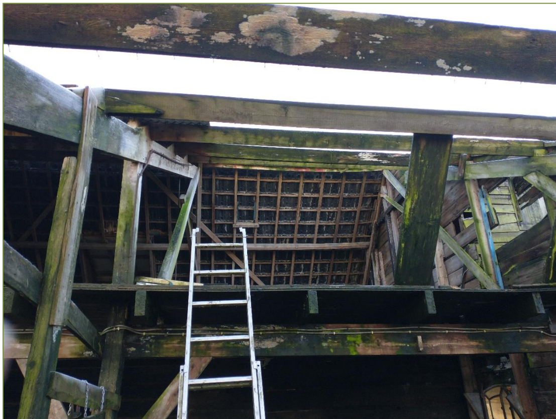
Foto 1: een deel van een schuur vanaf de voormalige varkensstal gezien. Aan de noordzijde is het dak ingestort. Op de zuidzijde zijn de dakpannen vanuit de schuur zichtbaar. In de schuur zijn geen sporen aangetroffen van vogels.
