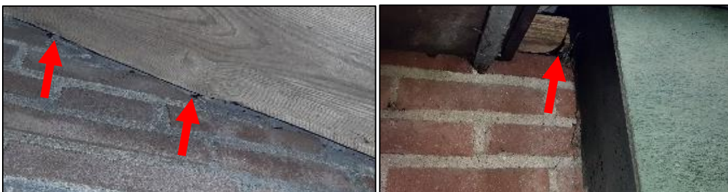
Afbeelding 5: Voorbeelden van openingen (rode pijlen) onder de (af-) daken van de stallen aan de West Vlisterdijk 32 te Vlist die gebouwbewonende vleermuissoorten toegang naar geschikte ruimtes kunnen bieden (Foto's: Laneco, 2022).
