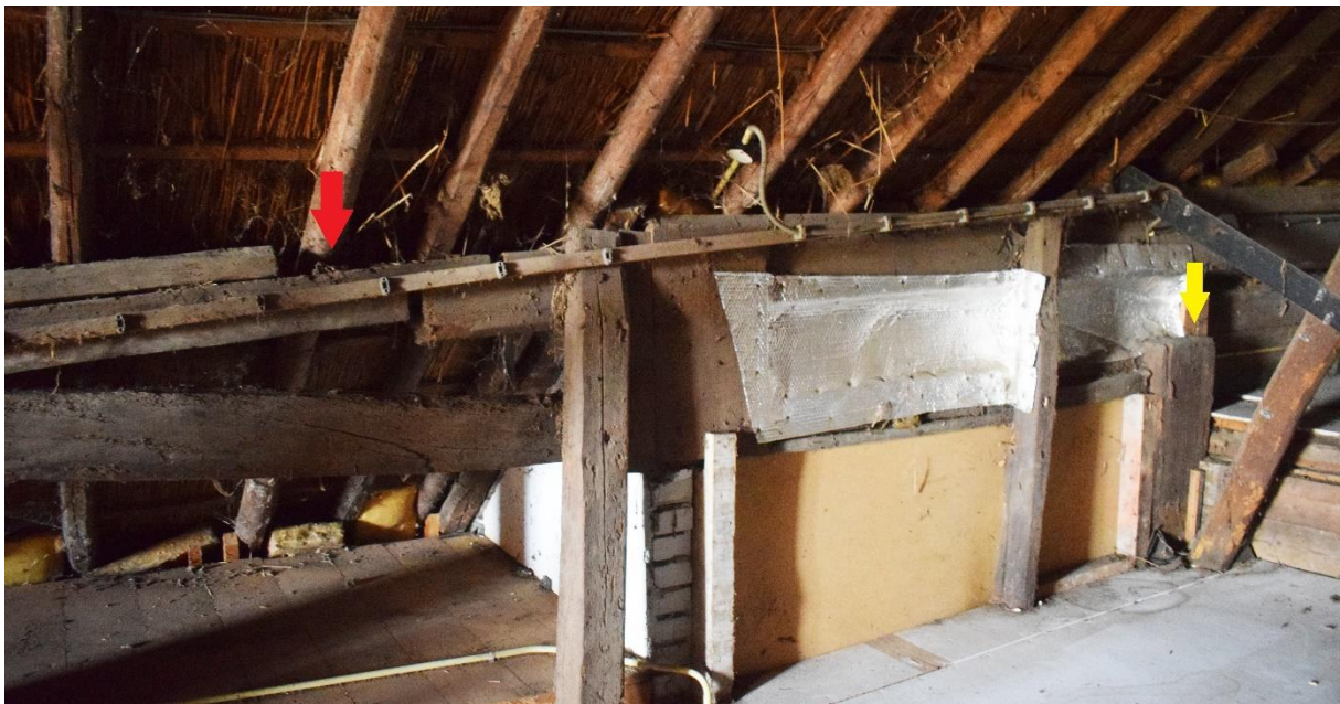
Figuur 13. Verhoogde kap bij het woongedeelte achter de brandmuur. De gebintplaat is hier plaatselijk omhoog gebracht (rode pijl) en ligt niet meer op de gebintstijl (gele pijl).
