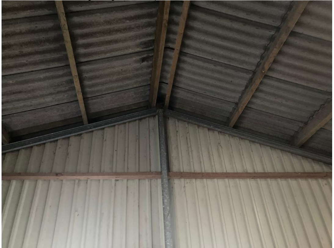
• Afbeelding 10: Ongeïsoleerde dakplaten
