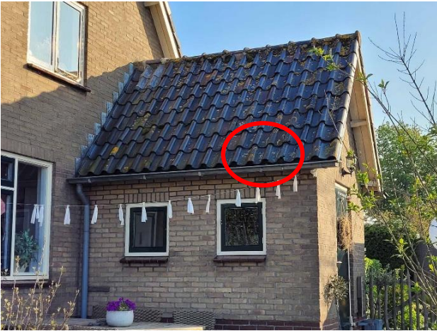
Figuur 6 Locatie nest oostzijde aanbouw bereikbaar via dakgoot onder pan oostzijde
