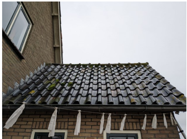
Figuur 33 Detailfoto slecht aansluitende dakpannen
