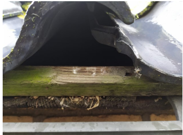
Figuur 16 Toegang tot de dakpannen met sporen van vogels
