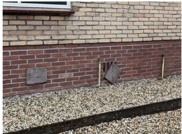
Figuur 29 Lage ventilatiegaten deels dicht gemaakt met hout
