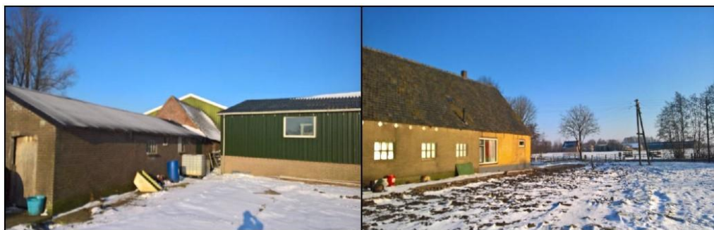
Figuur 4 Weergave van de locatie waar de schuur ingestort was. Restanten zijn reeds verwijderd.
