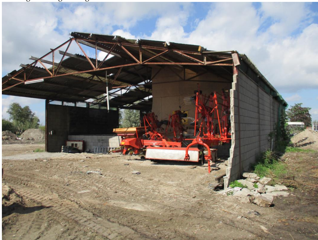
Figuur 5 De jongveestal vanaf het zuiden, het metalen frame is nog intact en het golfplaten dak is kapot met grote gaten.
