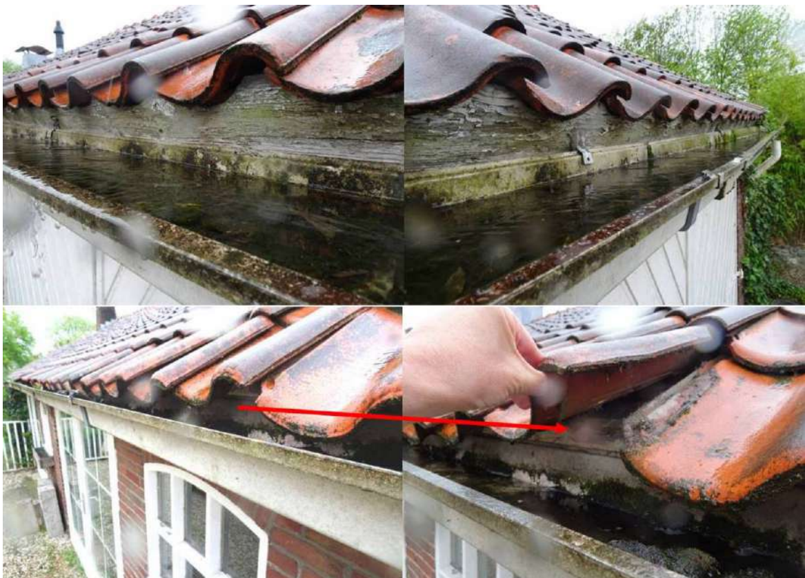
Figuur 6. Lat onder de onderste dakpannen van de schuur aan de IJsseldijk West 13 te Ouderkerk aan den IJssel op dinsdag 10 mei 2023 waardoor deze ongeschikt is als nestplaats voor de huismus (er is onvoldoende toegangsruimte).
