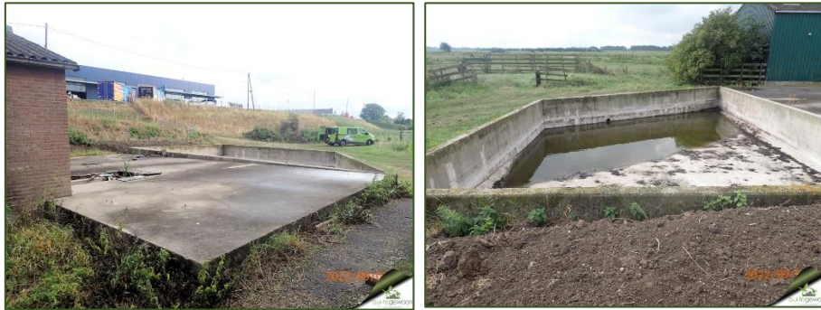
Figuur 8. Mestkelder afdekking en mestopslag
