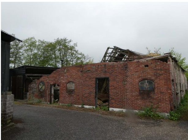
Figuur 6 Ingestorte schuur
