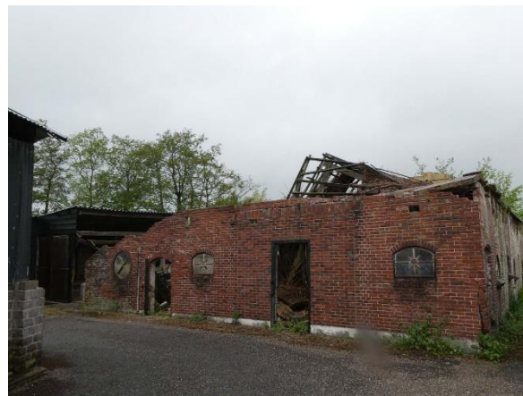
Figuur 15 Impressie bouwkundige staat ingestorte schuur
