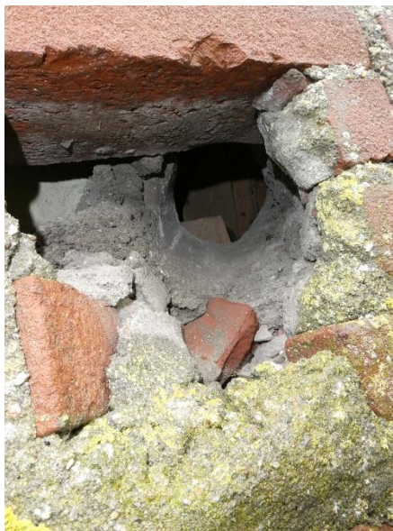
Figuur 17 Impressie bouwkundige staat oude varkensschuur
