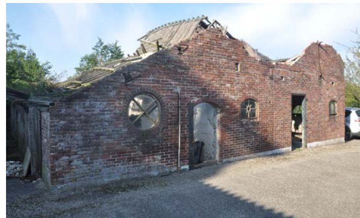
Bouwvallige schuur op het erf met betonverharding
