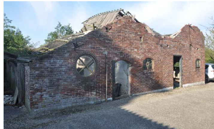
Bouwvallige schuur op het erf met betonverharding
