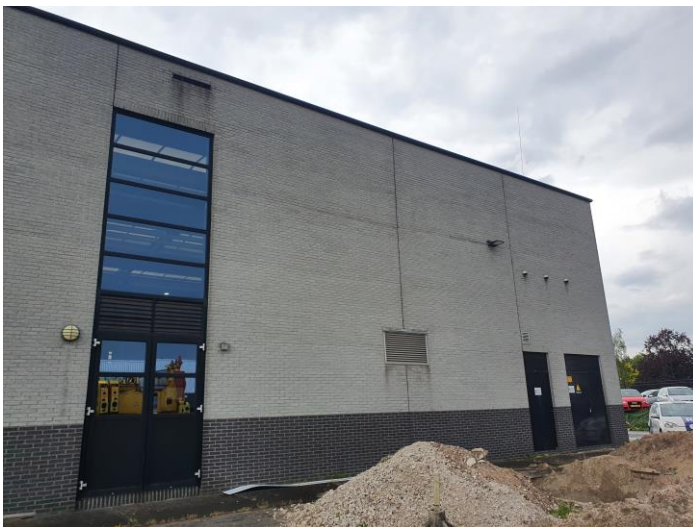
Figuur 6: Detail van de gesloten zijgevel met op enkele plekken open stootvoegen
