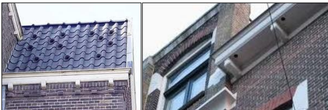
Figuur 9: Links: speciale pannen; rechts ruimte in de gootbetimmering
