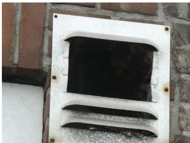
Figuur 20 Ventilatie gat met in de muur
