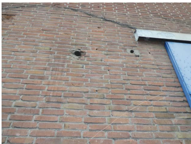
Figuur 19 Ventilatie gaten zonder afdekking
