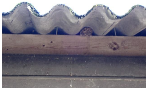
Foto 10: Perceel 30a, aan de oostzijde van de kalverenstallen 1 en 2 zijn onder de dakbedekking nesten van gierzwaluwen te zien.
