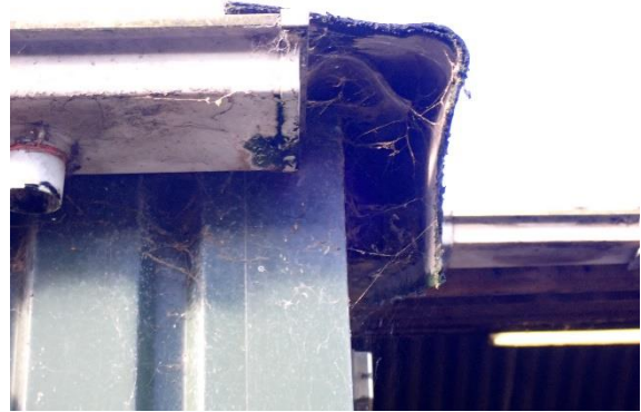
Foto 16: Perceel 30a, opening in de dakbedekking van kalverenstal 3 en 4 is potentieel geschikt voor vleermuizen, huismussen en gierzwaluwen.
