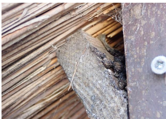
Foto 7: Perceel 30a, opening onder het rietendak is zichtbaar al gebruikt door een vogel, waarschijnlijk de huismus.
